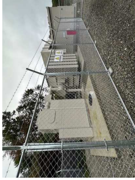
連系変電設備
