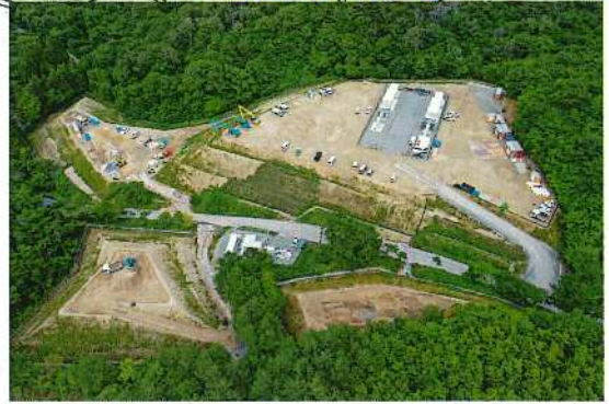
③変電設備用地
